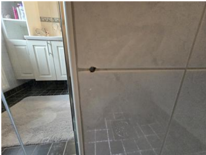
Dusch/WC: Bristfälligt tätade hål i dusch.
