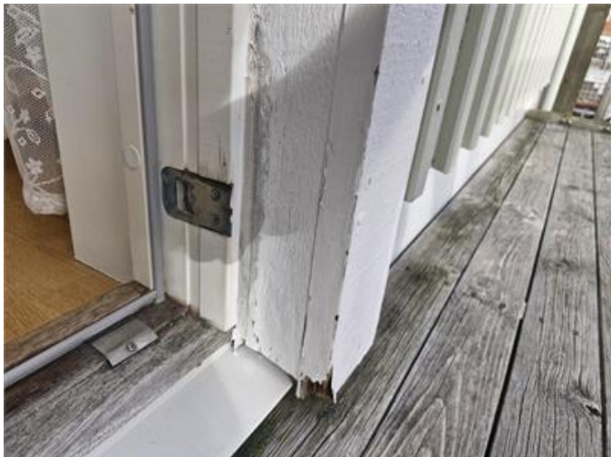
Fasad, rötskador i ändträ på foder/smyg söder.
