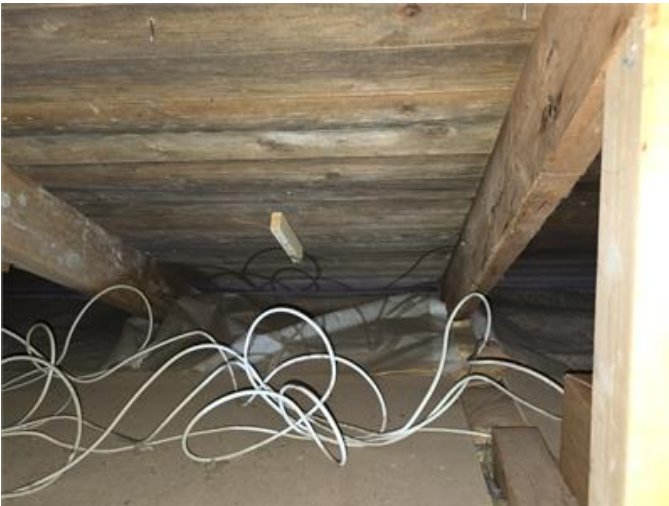
Nockvind: Mikrobiell påväxt/missfärgningar i underlagstak.
