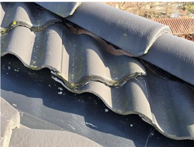
Tak: Nocktätning bristfälligt monterad.
