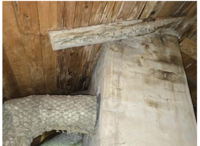
Nockvind: Äldre fuktfläckar runt murstock.
