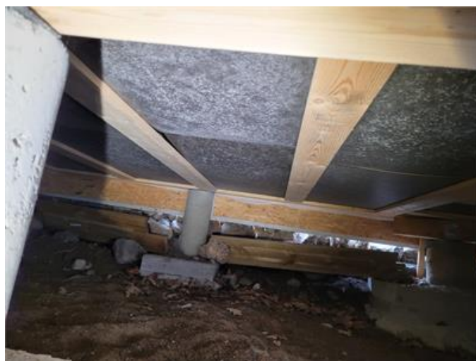
Mikrobiell påväxt på blindbotten.
