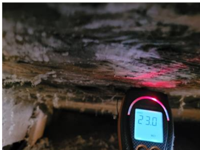
Mikrobiell påväxt på underlagstak
