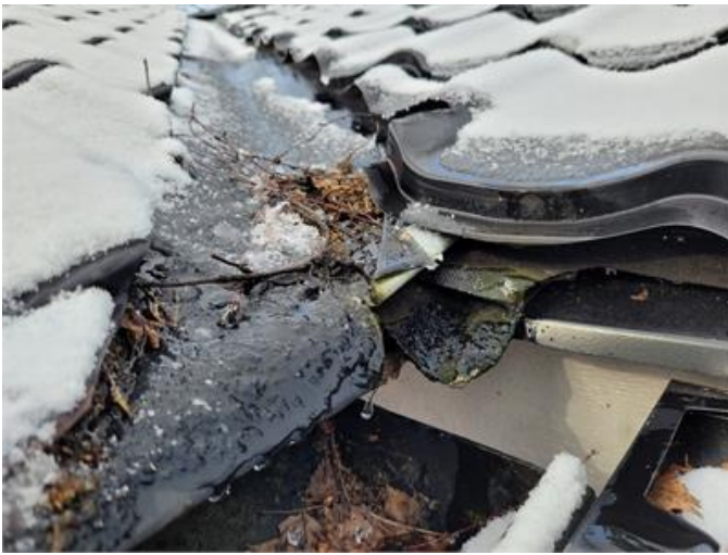
Rännalsplåt med åtgärdsbehov
