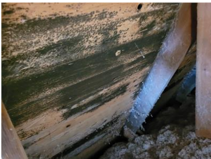
Mikrobiell påväxt på underlagstak
