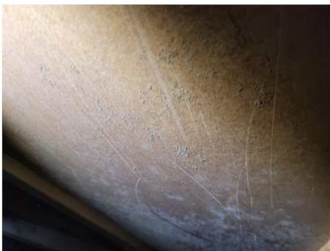
Mikrobiell påväxt på blindbotten.
