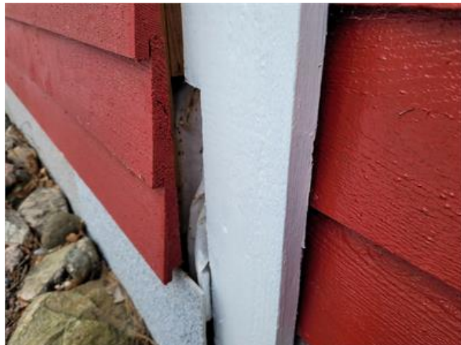
Otätthet på fasad i skarv mellan original hus och tillbyggnad
