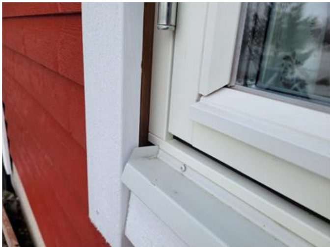
Otättheter runt fönster samt bakfall på fönsterbleck.
