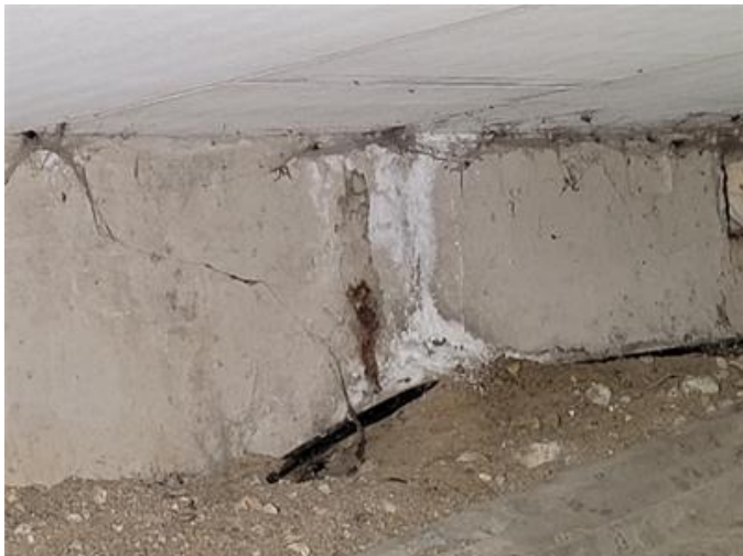
Kalkutfällningar på grundmurens insida
