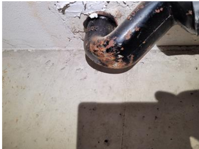
Rost på golvbrunn.
