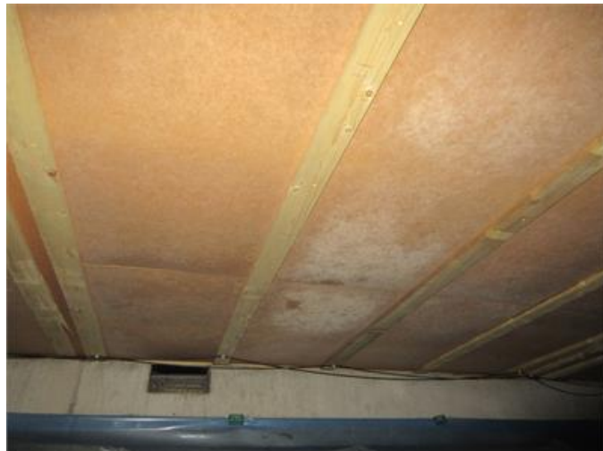
Mikrobiell missfärgning på träfiberskiva i grunden
