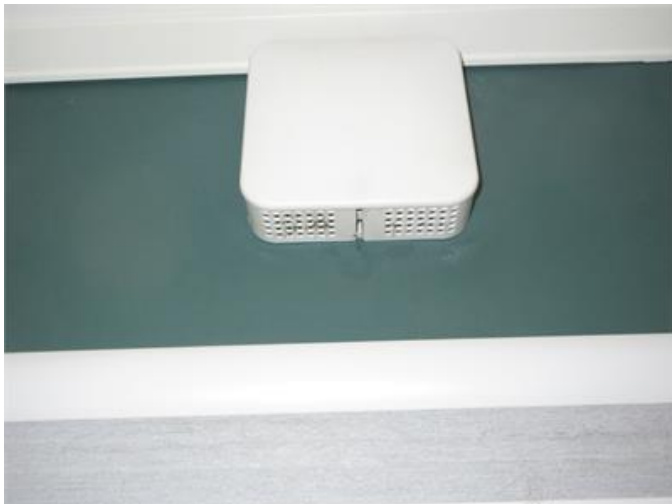
Fuktfleck på vägg under friskluftsventil
