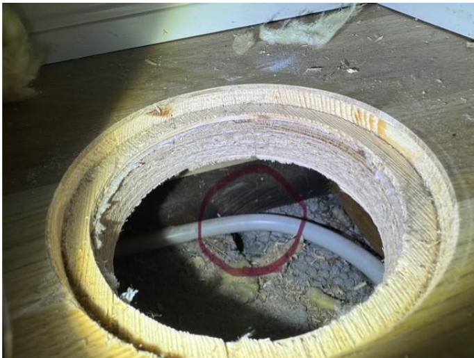
Bild visar luftläckage mellan lecastenar.
