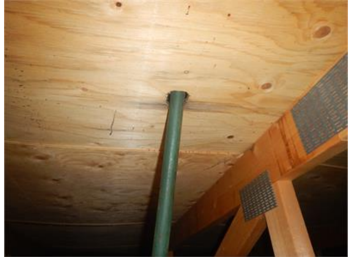
Fuktpåverkan på underlagstak vind
