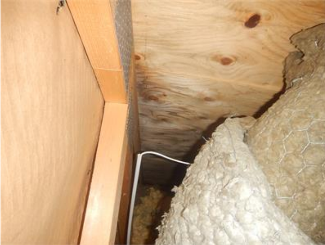
Fuktpåverkan på underlagstak vind.
