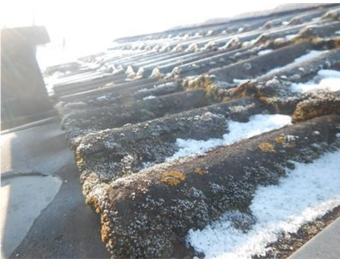
Mossa/lav på takpannor samt färgsläpp på plåtdetalj.
