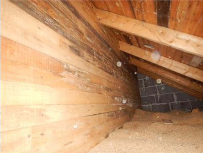
Mikrobiell påväxt på underlagstak samt stödbensvägg.
