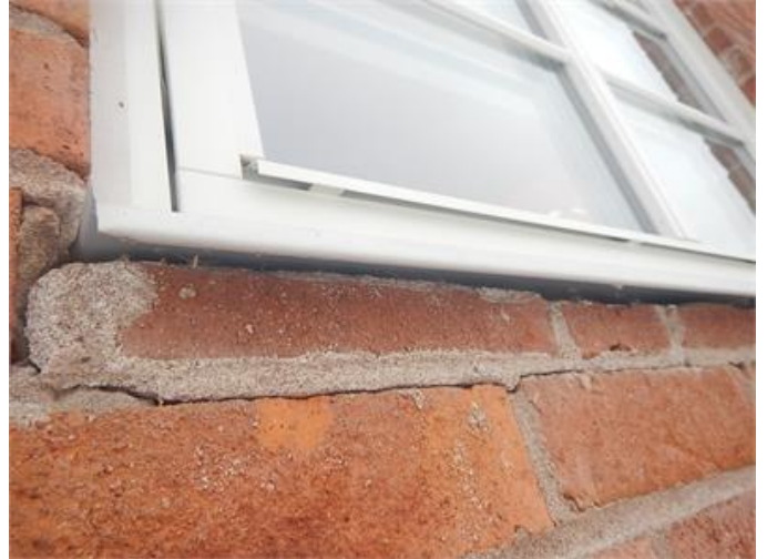
Sprickbildning och lösa tegelstenar på fasad.
