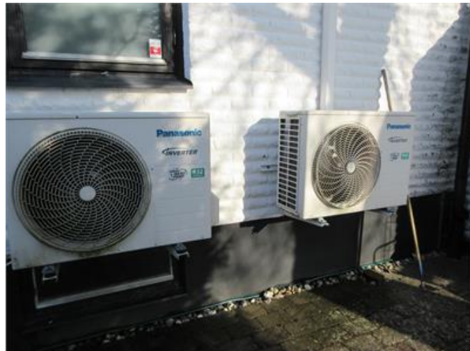
Luftvärmepumparna som är placerade vid fasaden
