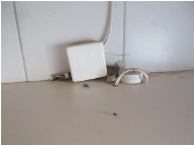
Oskyddad elkabel ovanpå badrumsskåp
