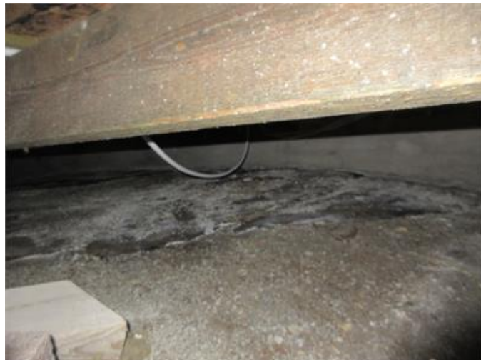
Mikrobiell påväxt på marken i krypgrunden
