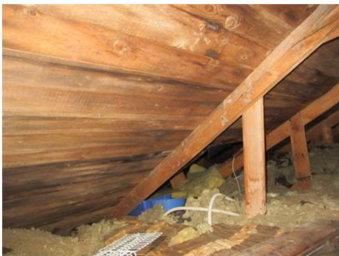
Mikrobiell missfärgning på vinden
