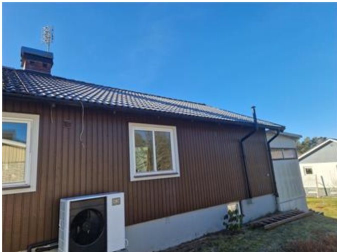
Vy på yttertak med frost/isbeläggning
