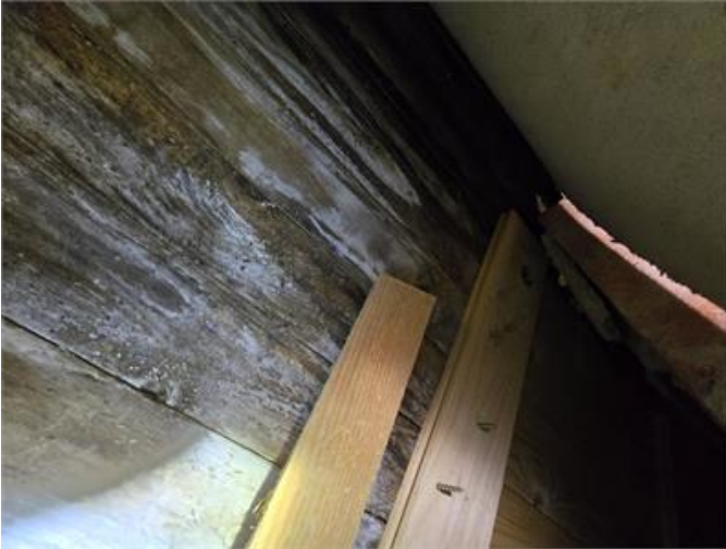
Mikrobiell påväxt/missfärgningar på underlagstak vid murstock på Sidovind mot nordväst.
