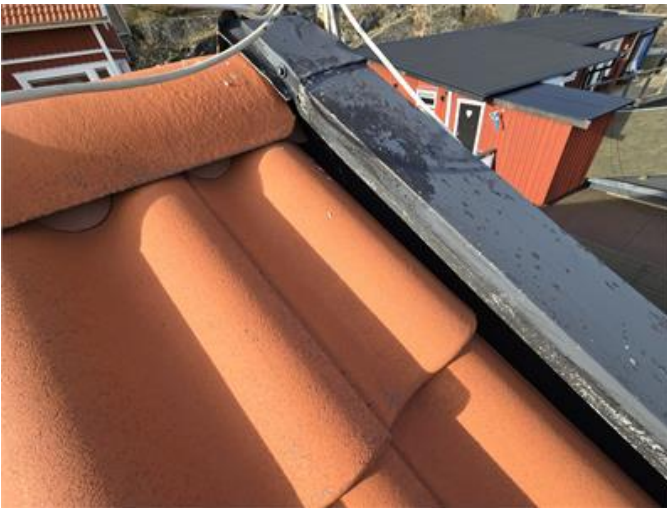
Otättheter vid vindskiveplåt på Tak.
