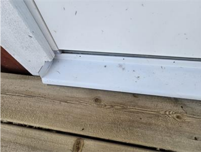
Tröskelplåt ej infäst.
