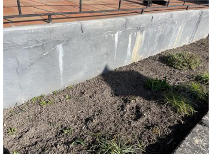
Grund med underhållsbehov i anslutning till altan.
