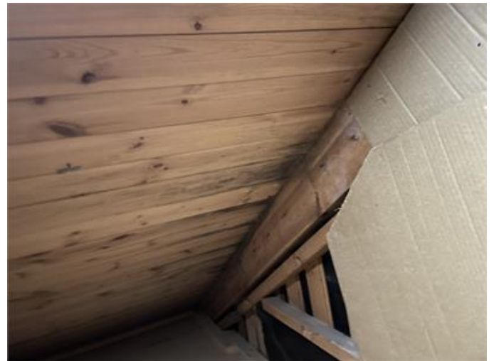
Lokal missfärgning vindsutrymme. Ingen förhöjd fukt uppmättes i takkonstruktionen vid besiktningen.
