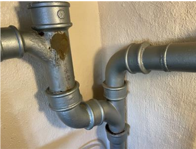
Äldre avloppstam källare med rostangrepp.
