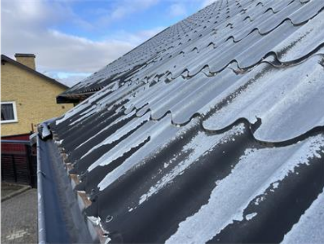
Plåttak med färgsläpp och nocktätning som trillat bort och rekommenderas att återmonteras.
