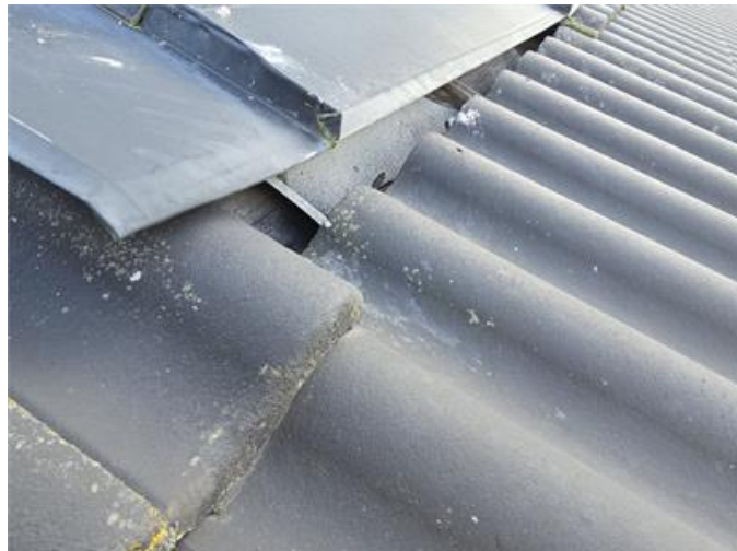
Bilden visar takpannor som täcker bristfälligt i anslutning till skorsten.
