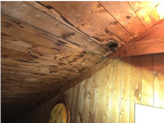
Exempel på fuktfläckar i underlagstaket.
