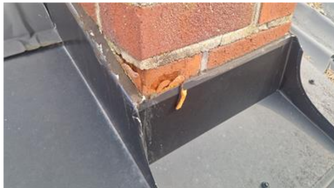
Bild på skorsten med lokal skada
