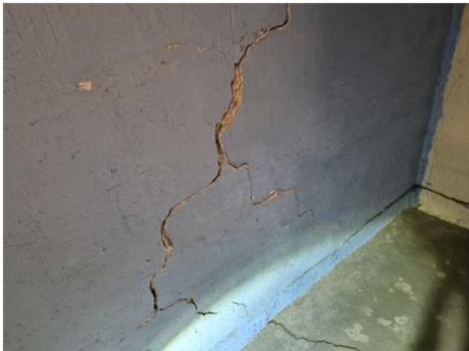
Sprickor i grunden.
