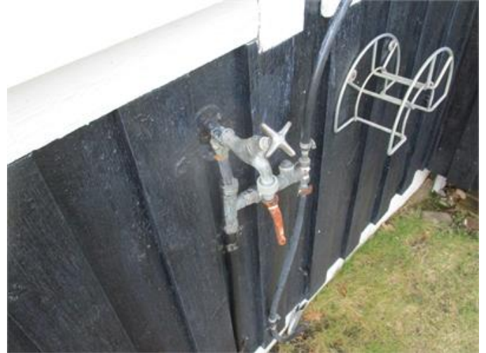
Väggvattenutkastare och rör ej frostsäkra.
