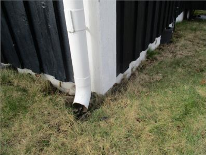
Stuprör mynnar intill grundmur.
