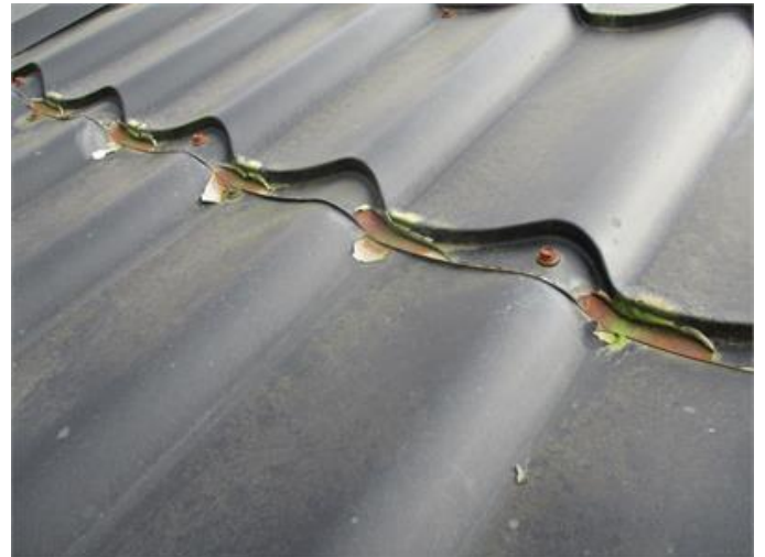
Färgsläpp på plåttak.
