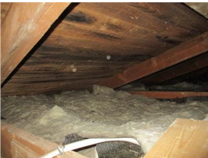
Mikrobiell påväxt på underlagstak.
