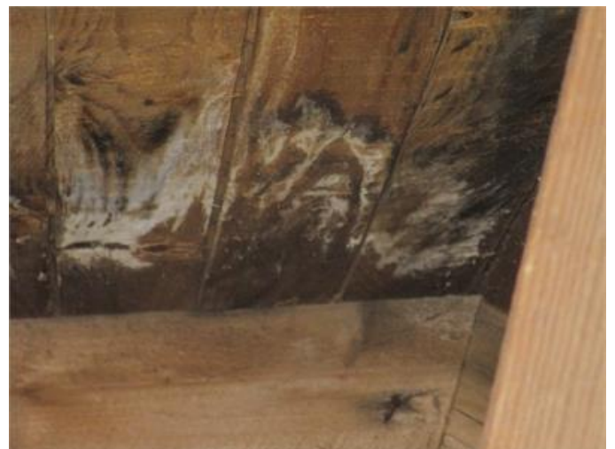
Gamla fuktfläckar i underlagstak intill skorsten.
