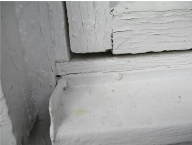
Botten av fönsterbåge kasat ned.
