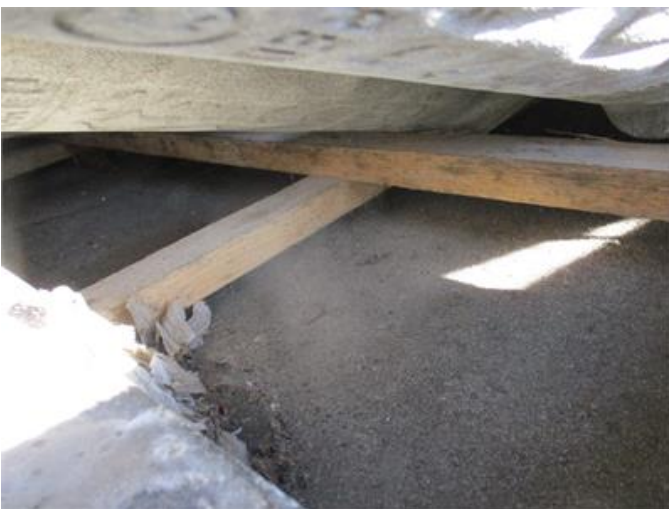
Undertakspapp och läkten i bra skick.
