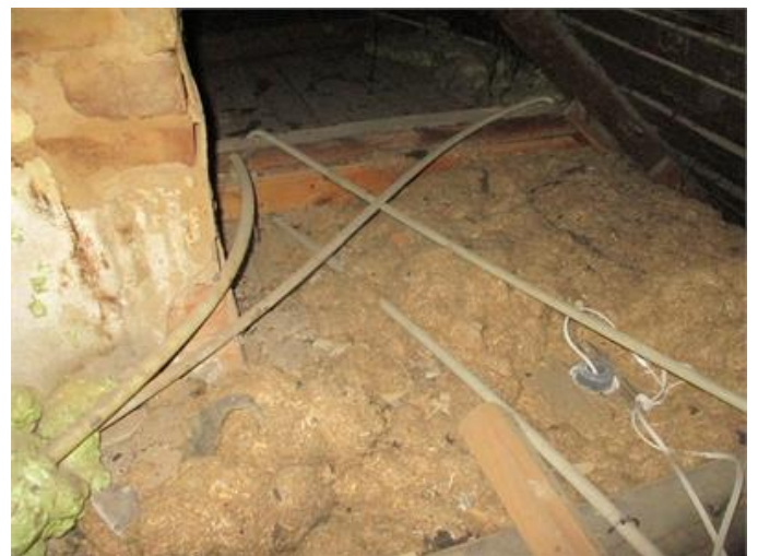
El-dragningar bristfälligt utförda.
