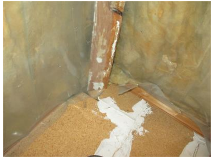
Otättheter i plastfolie på vind över utbyggnad.
