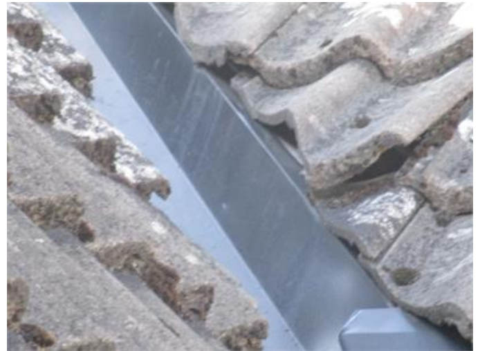
Takpannor täcker ej tillräckligt över rännalsplåt.
