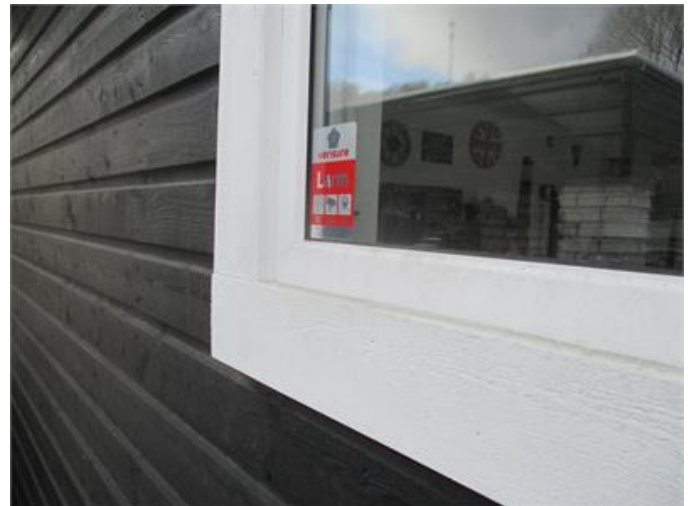
Garagefönster utan dropplåt.
