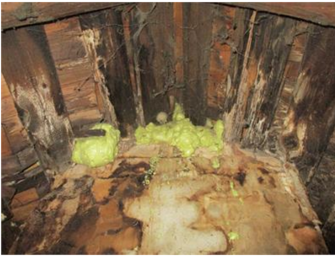
Fuktfäckor på skorsten anslutande tak.
