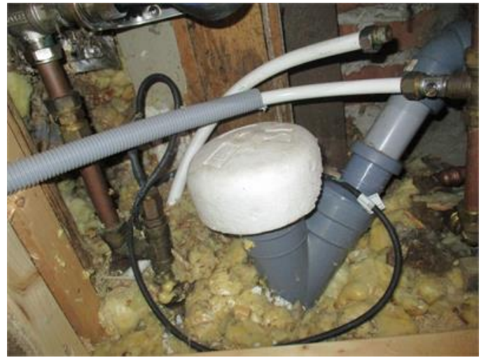
Luftningsventill och oklamrade rör i skrub i hall.
