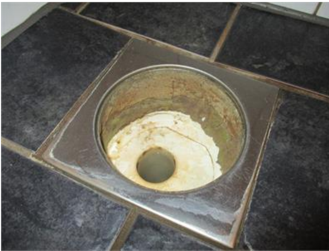
Golvbrunn ej i nivå och saknar en klämring.
