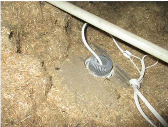
Bristfälligt isolerat vindsbjälklag. kåpa saknas över takspotlight.
