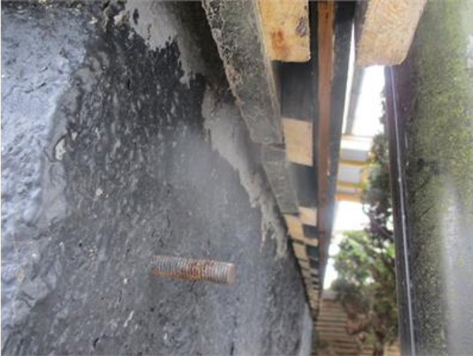
Ändträ i knutbräda och äldre fasad ej färgtäckt.
