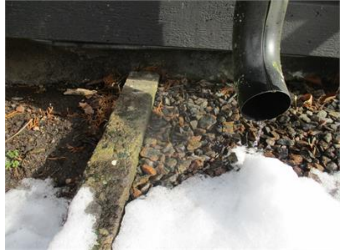
Rabatt intill sockel och stuprör mynnar nära hus.
