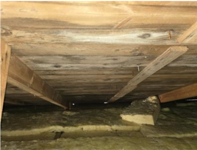
Mikrobiell påväxt på underlagstak.
