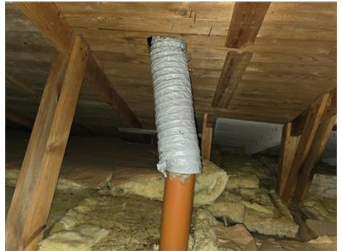
Imkanal (Rör till köksfläkt) bristfälligt utförd och ej brandsäker.
