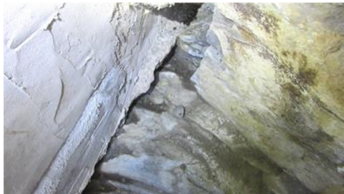
Inträngande vatten i krypgrund.
