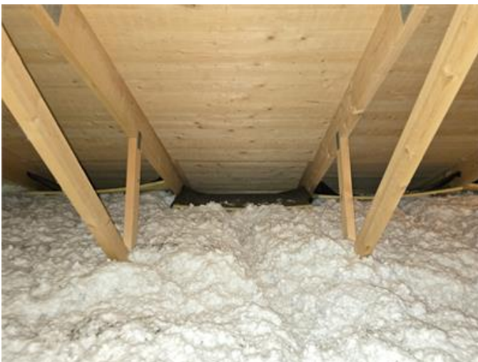
Nedfallen vindavdedare på Nockvind.
