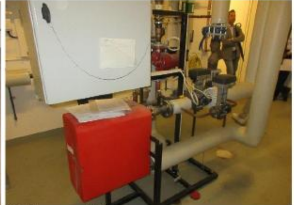
Undercentral för varmvatten
