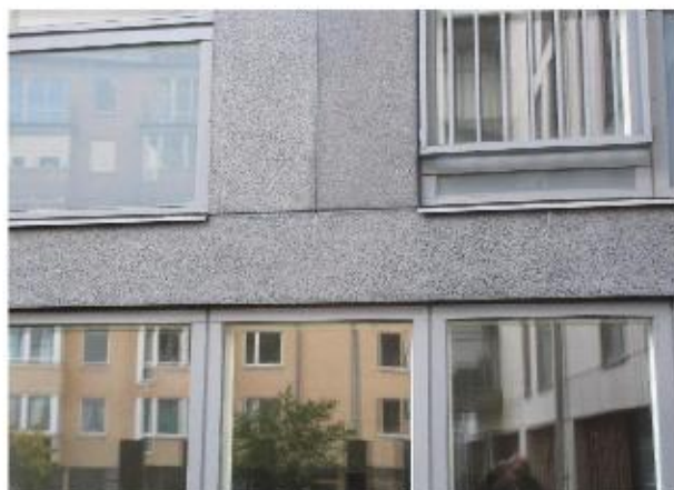
Sprickor i fasaderna
