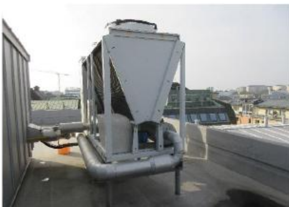
Kylaggregat för höga byggnadens lägenheter
