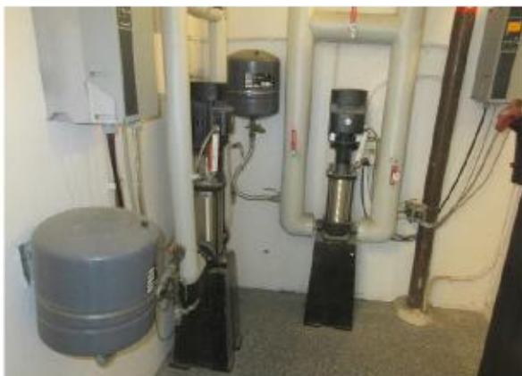
Tryckstegringspumpar för tappvatten
