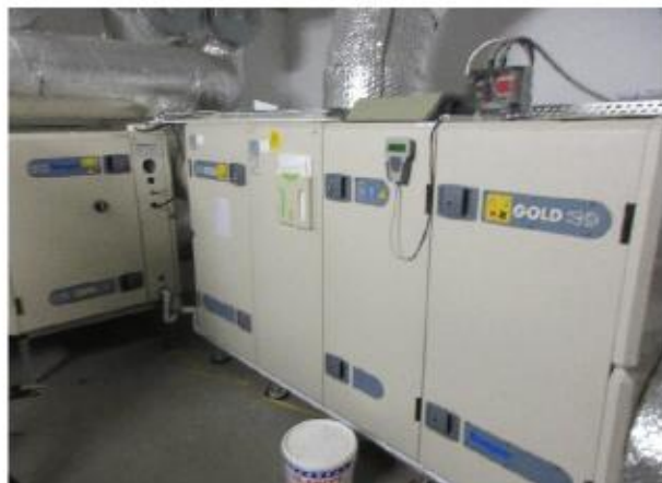
Ventilationsaggregat för allmänna utrymmen.
