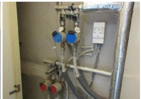
Individuell mätning av kall- och varmvatten
