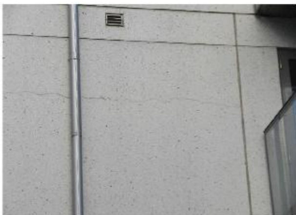
En av många sprickor i fasaderna.
