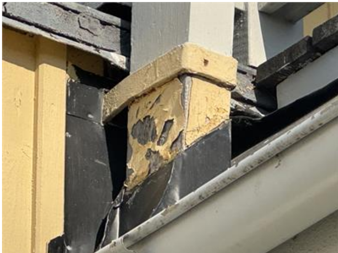
Bärande pelare till balkong som varit fuktutsatt.
