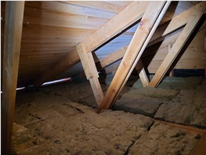
Mikrobiell påväxt på underlagstak
