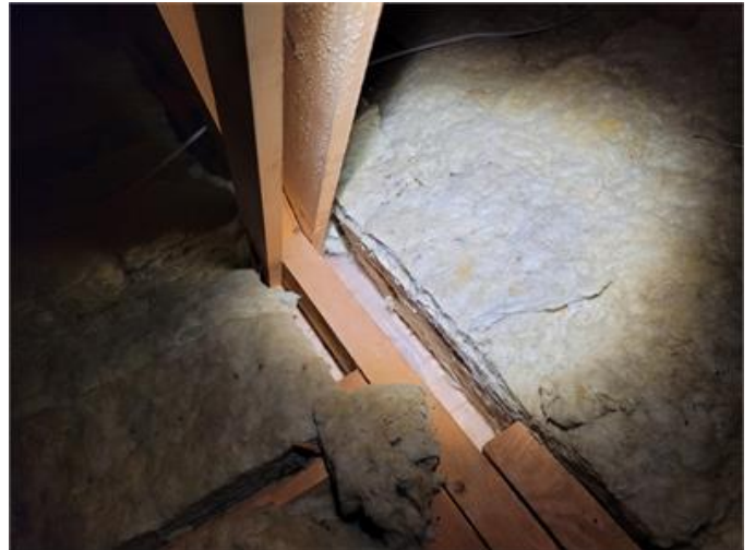
Isolering med justeringsbehov
