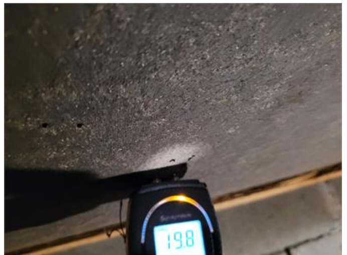
Förhöjd fuktkvot uppmätt i blindbotten
