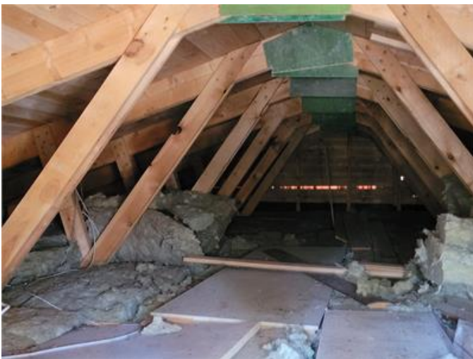
Isolering med justeringsbehov
