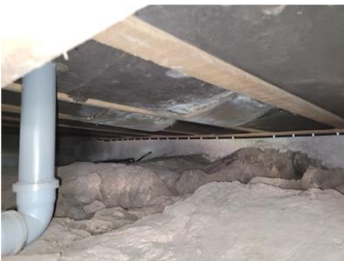
Mikrobiell påväxt på blindbotten
