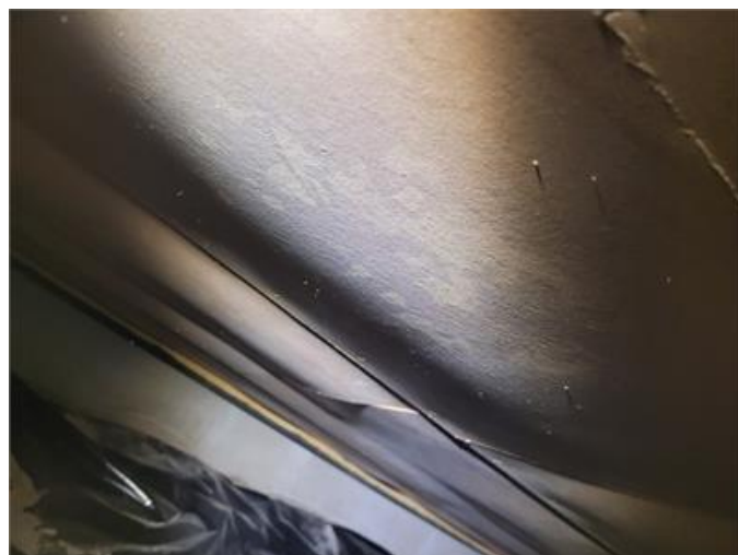
Mikrobiell påväxt på blindbotten.
