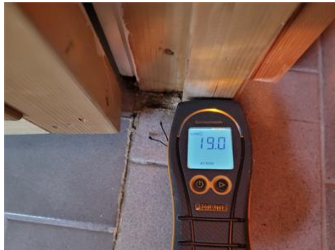
Förhöjd fuktkvot i dörrkarm.
