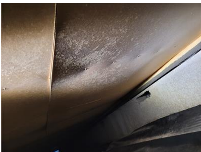
Mikrobiell påväxt på blindbotten.
