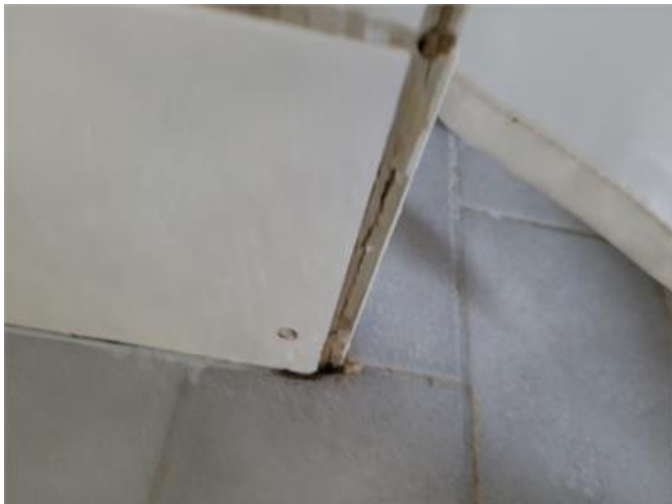
Sprickor i kakelfog.
