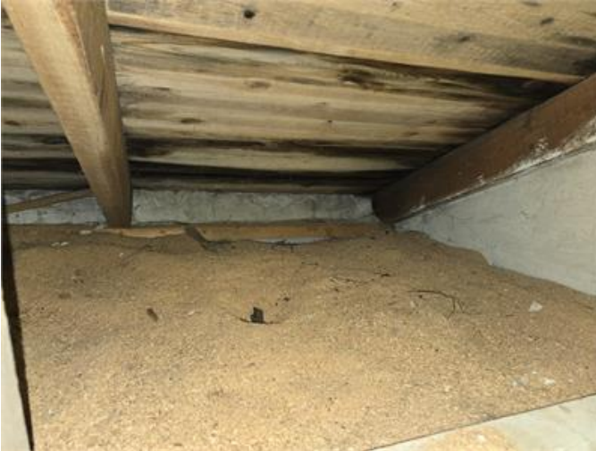
Exempel på del av vind och mikrobiell påväxt/missfärgningar.
