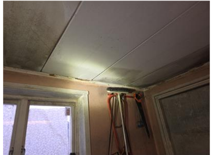
Missfärgningar i innertak, garaget.
