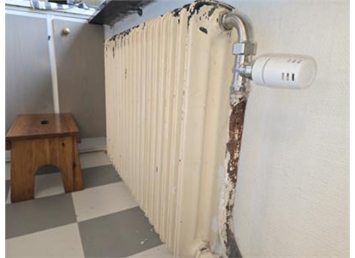
Exempel på rostangrepp i radiatorkoppel.
