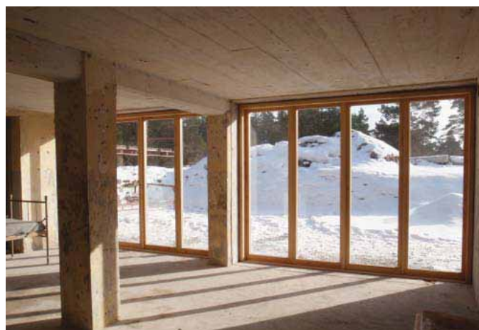
Den tidigare slutna byggnaden har numer glaspartier mot söder och den nedsänkta gården.
