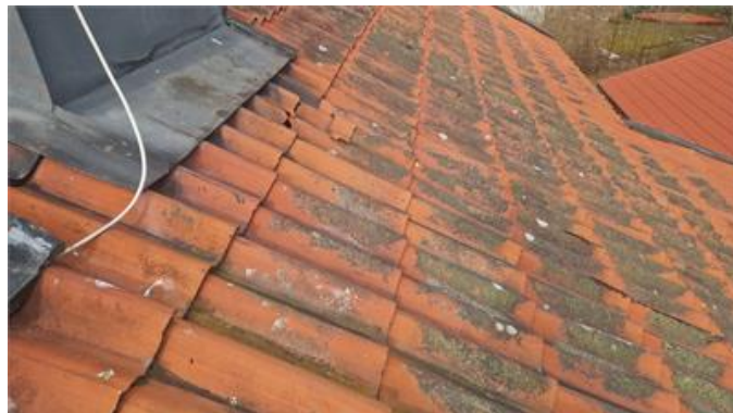
Bilden visar delar av taket med trasiga tegelpannor
