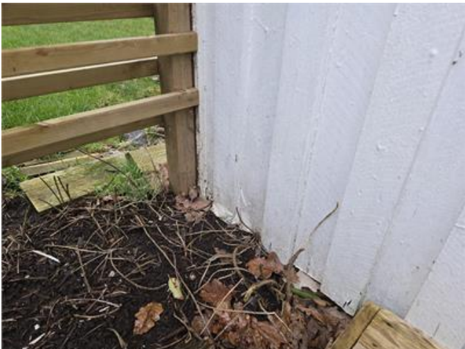
Hörn där panel ligger an mot mark och är rötskadad.
