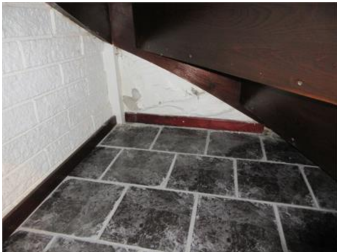
Putssläpp på källarvägg.
