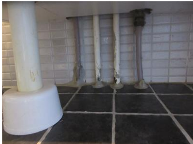
Rör genomföring i våtrumsgolv
