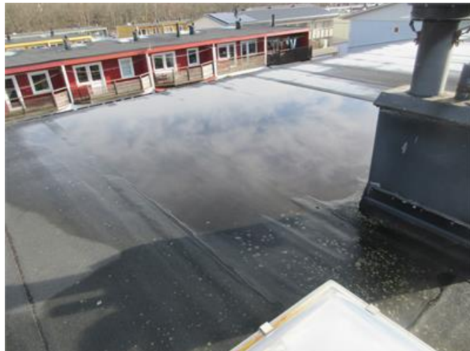
Vattenansamling på yttertaket
