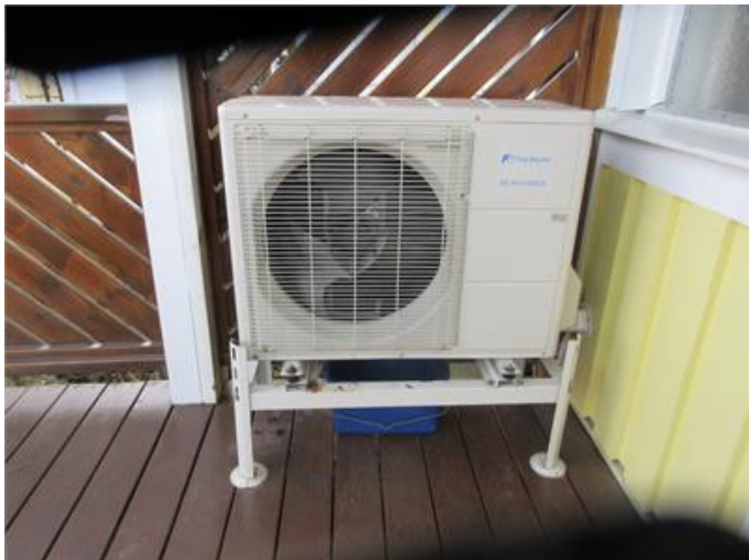
Luftvärmepumpen vid fasaden
