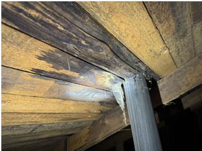
Fuktrelaterade missfärgningar invid genomföring.
