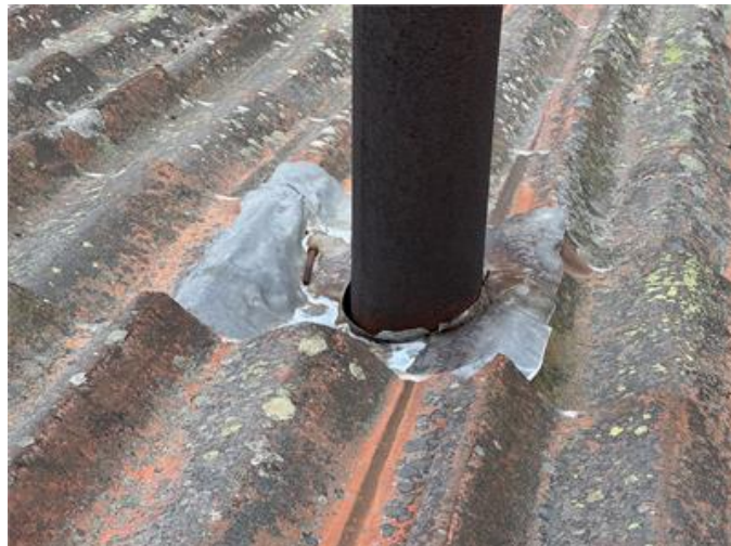
Otät genomföring på taket.
