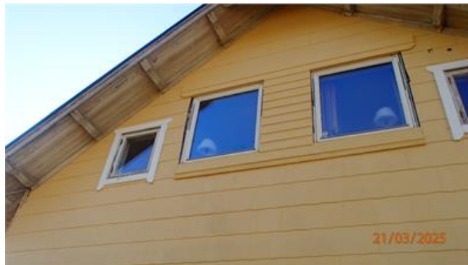
Avslutningar saknas runt fönster.
