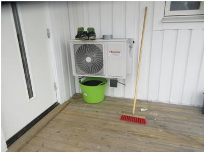
Värmepumpens utomhusdel vid fasaden
