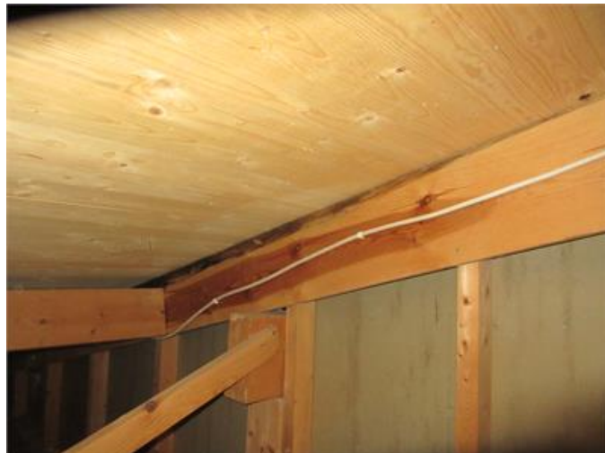
Missfärgning på takstolen. Se även lämnad information.
