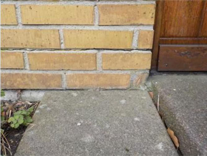
Brister/spricka i tegelfog i anslutning till entrétrappan.
