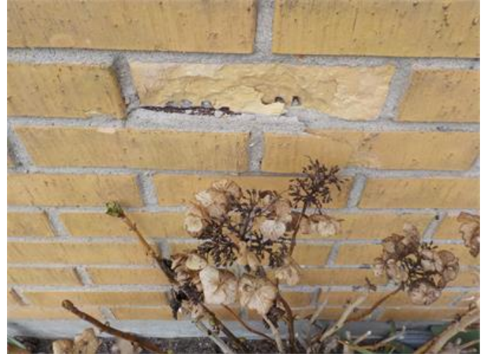
Skada i tegel, troligen pga. rost i armeringsjärnet.
