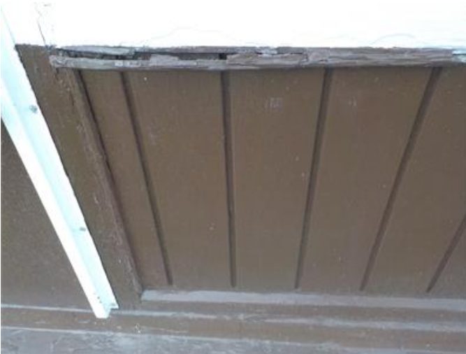
Skada i list under vardagsrumsfönster.
