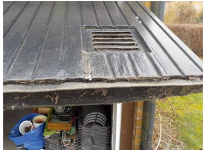
Rötskador i nederdel garageport.
