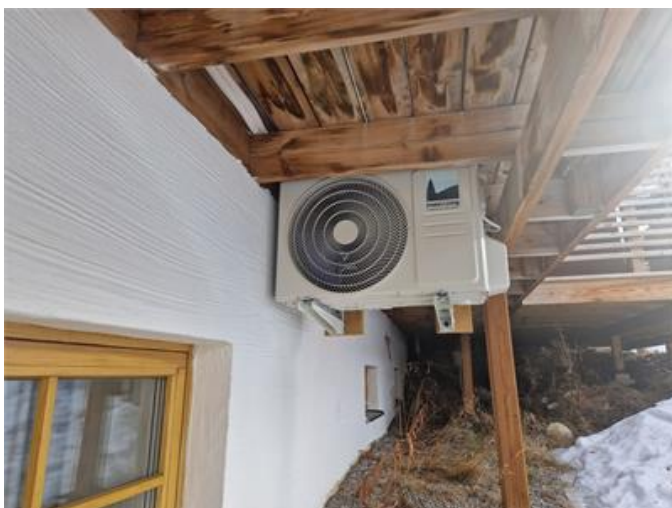
Kondensvatten från luftvärmepumpens utedel leds ej bort från grund.
