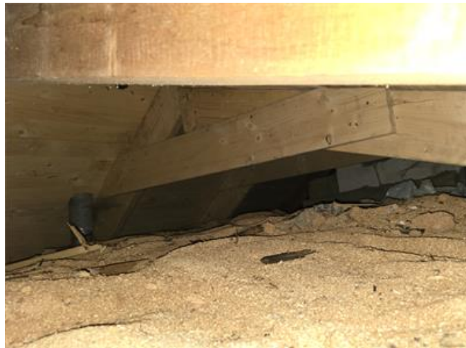
Översiktsbild Nockvind från lucka, oisolerat ventilationsrör.
