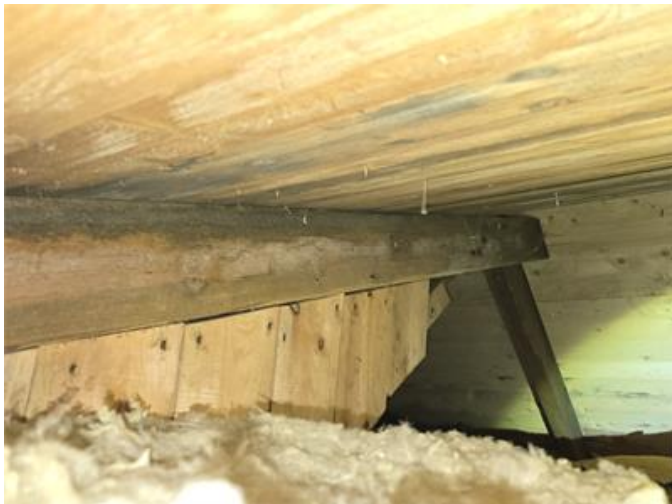
Översiktsbild Nockvind från lucka, mikrobiell påväxt/missfärgningar.
