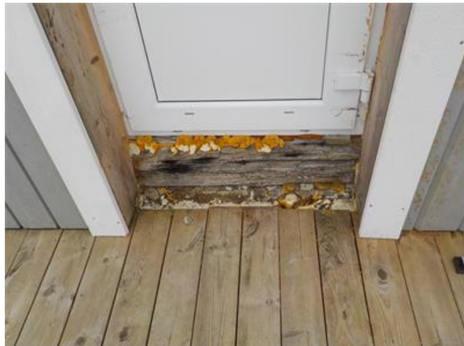
Det är inte färdigställt vid nederdel dörrparti.
