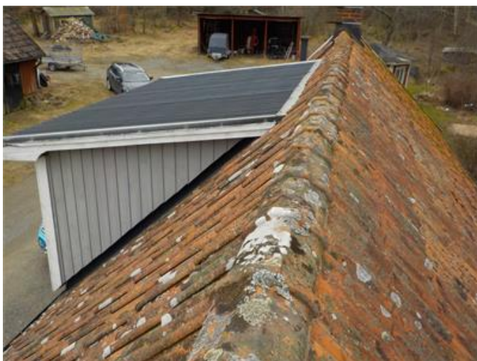
Låg taklutning för korrogerad plåt på kupan.
