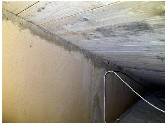
Mikrobiell påväxt på gipsvägg och underlagstak "vind".
