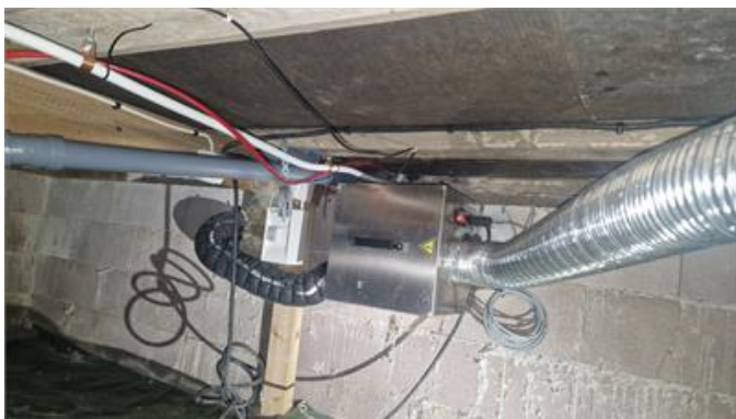
Bild på avfuktare i grunden
