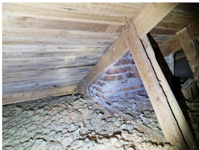
Nockvind, fuktanvisning i underlagstaket vid murstock, håll under uppsikt.
