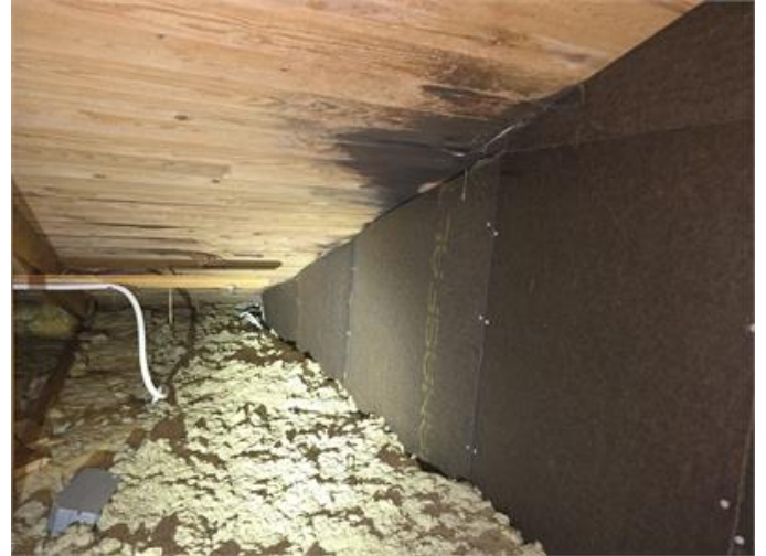
Exempel på mikrobiell påväxt på undersidan yttertaket.
