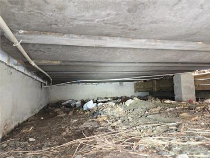
Överblick plintgrund, på undersidan av blindbotten noteras mikrobiell påväxt.
