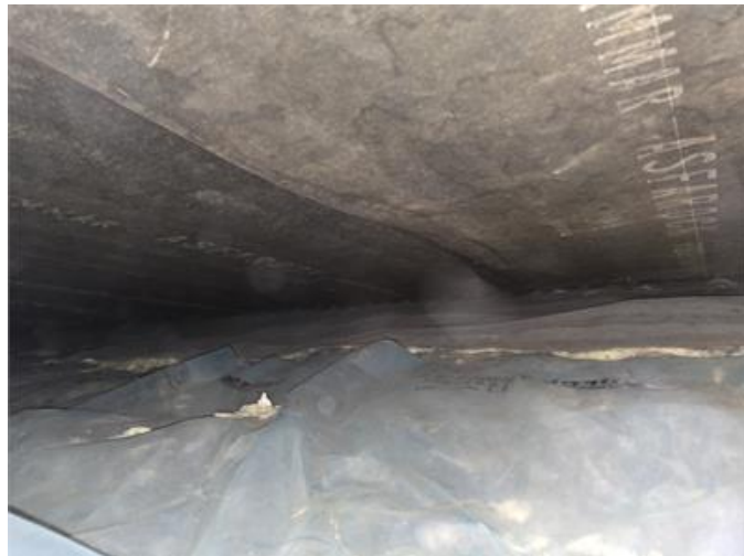
Exempel på asfaboard som hänger något.
