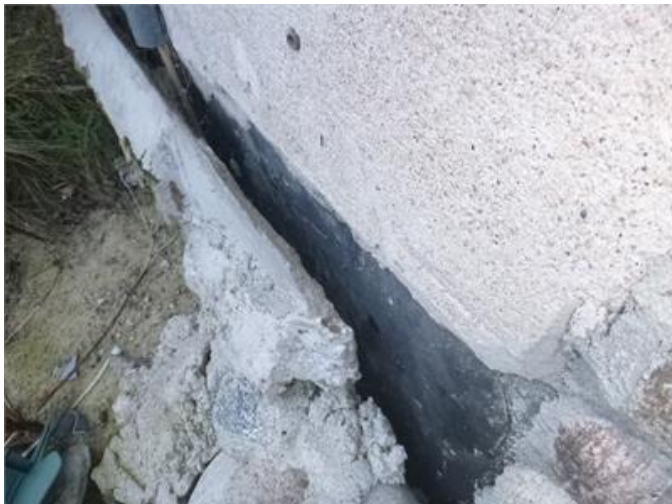
Bilden visar exempel på otätheter/brister vid/med grundisoleringen.
