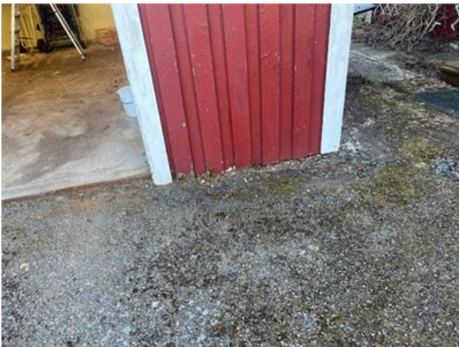
Pos 3. Fasad ligger delvis i kontakt med mark, vilket har orsakat rötskador i fasaden, bakomliggande skador kan ej uteslutas.
