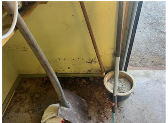
Pos 4. Fuktfläckar/missfärgningar förekommer på väggar invändigt.
