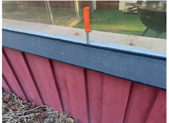
Pos 2. Fönsterbleck är bristfälliga under fönster.
