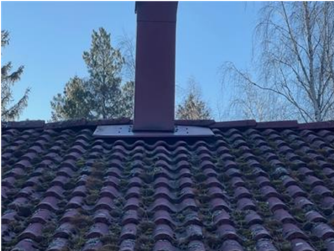
Pos 1. Stort avstånd förekommer mellan plåtbeslag och takpannor.
