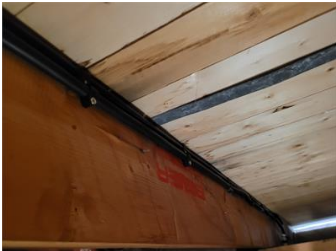
Fuktfläckar på underlagstak.
