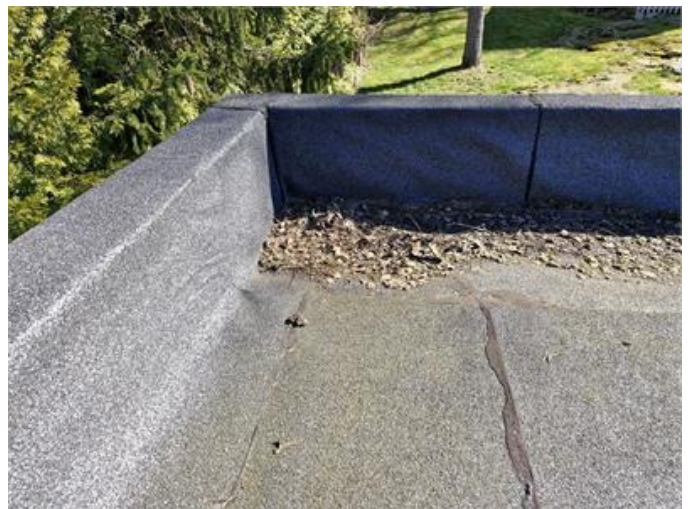
Tak, löv samlas vid inbyggda stuprör.
