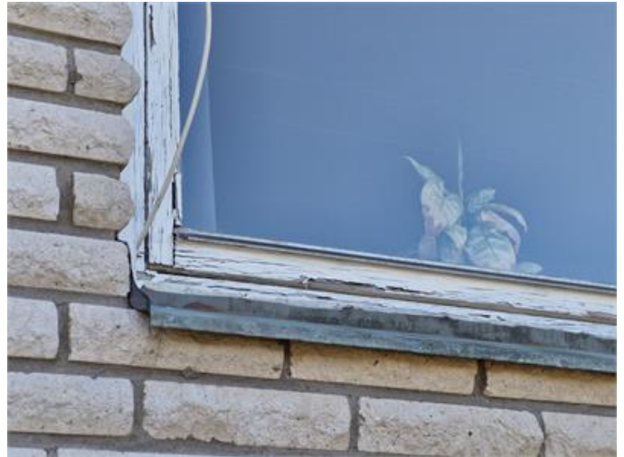
Fönster, flera äldre med underhållsbehov alt byte.
