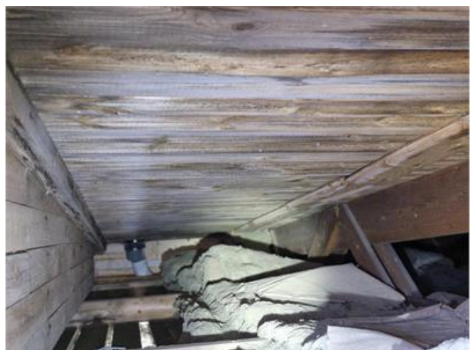
Nockvind, mikrobiell missfärgningar i underlagstaket.
