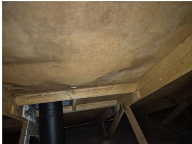
Fuktpåverkat undertak av masonit.
