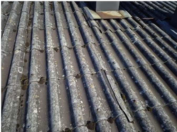
Äldre eternit tak med skador.
