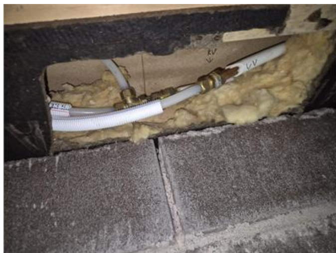
Saknas isolering bottenbjälklag krypgrund.
